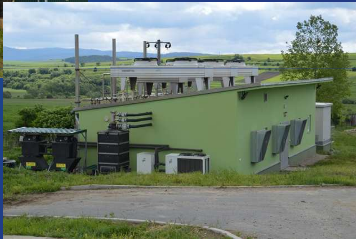
Strojovňa s chladičmi bioplynu a odsírením
