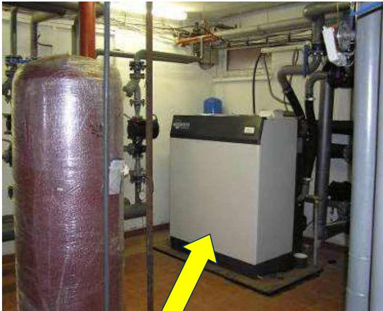
Strojovňa s tepelným čerpadlom
