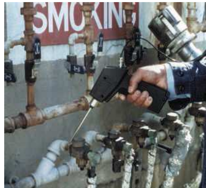
Meranie funkčnosti odvádzача kondenzátu
