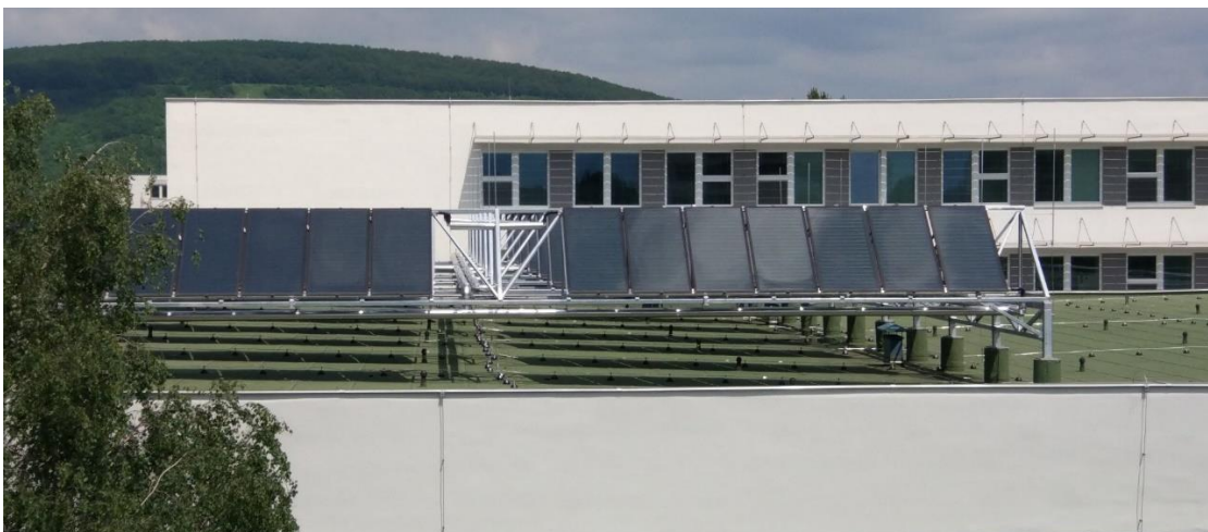
Fotovoltaický systém inštalovaný na streche budovy školy
