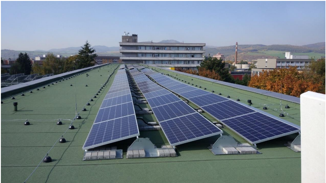
Fotovoltaický systém inštalovaný na streche budovy školyFoto: Michal Lešínský, Pio Keramoprojekt
