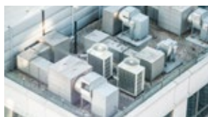
Vykurovanie, vetranie a klimatizácia (HVAC)
