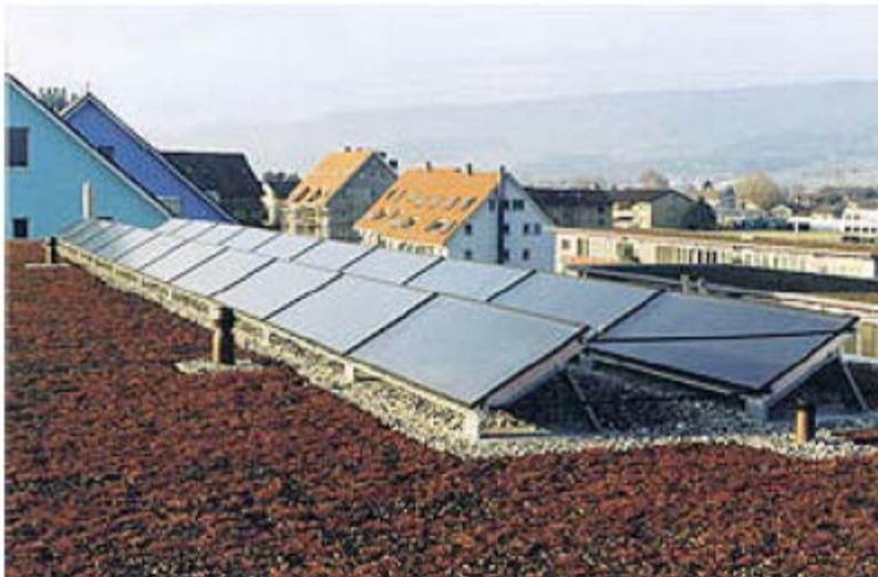
Samostatne nesené kolektory na rovnej streche
