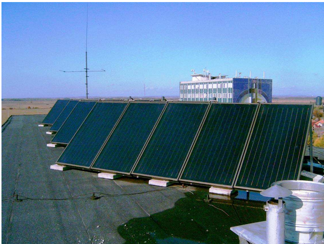
pohľad na časť kolektorov
