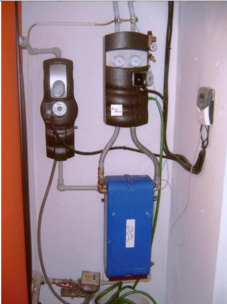
solárny výmenník, čeradlo a riadiaci systém
