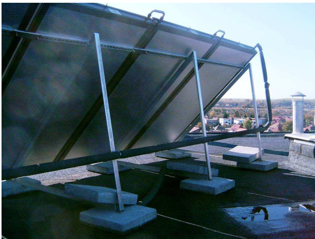
pohľad na kolektory zo zadnej strany
