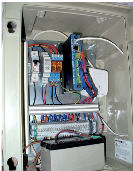
Zapojenie monitorovacieho zariadenia TISI
