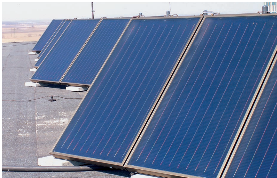
Celkový pohľad na sústavu slnečných kolektorov
