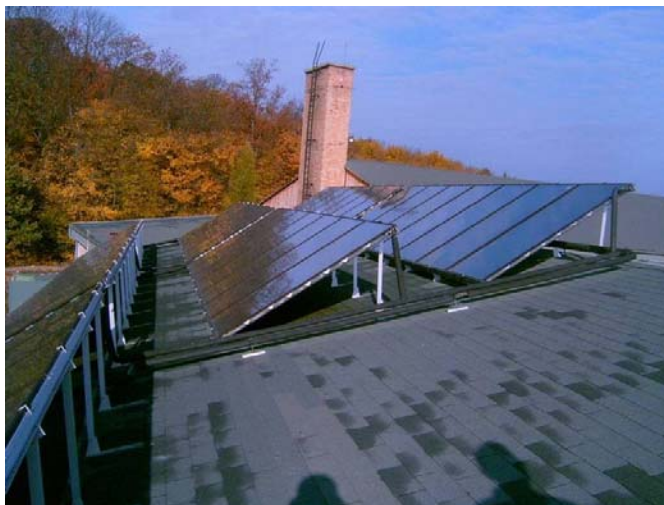
Obr. 3: Miesto: Drienok - Teplý Vrch Príprava teplej pitnej vody a vyhrievanie krytého bazénu
