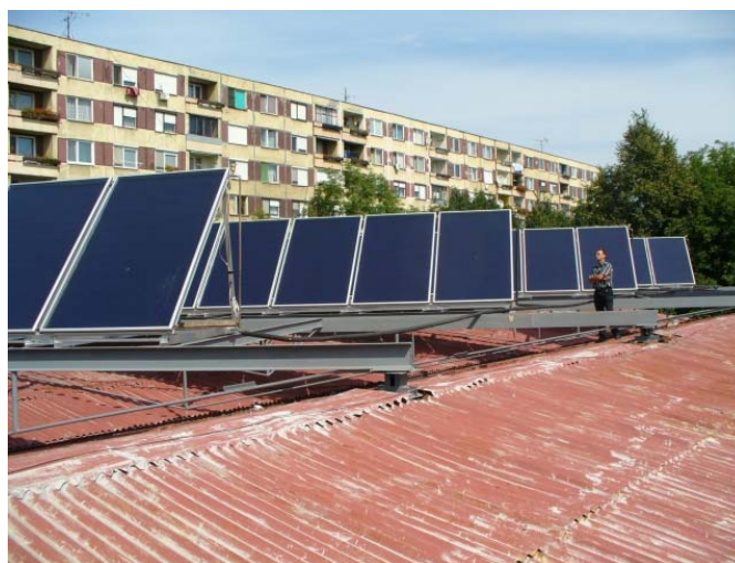
Obr. 6: Miesto: Komárno Príprava teplej pitnej vody
