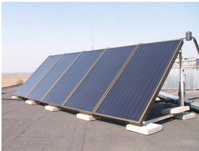
Obr. 1: Miesto: Šaľa 1 - Veča Príprava teplej pitnej vody pre 108 bytov
