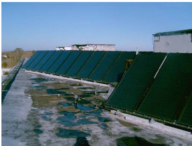
Obr. 2: Miesto: Šaľa 2 Príprava teplej pitnej vody pre 108 bytov
