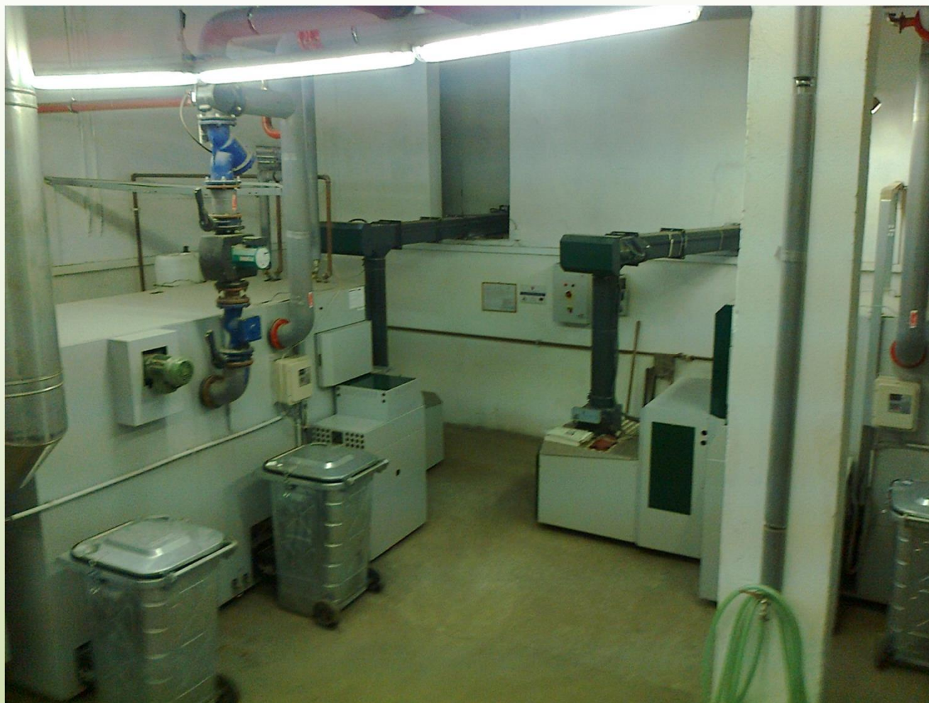
Rekonztruovaná kotolňa na drevnú ztiepku . firma Balog
